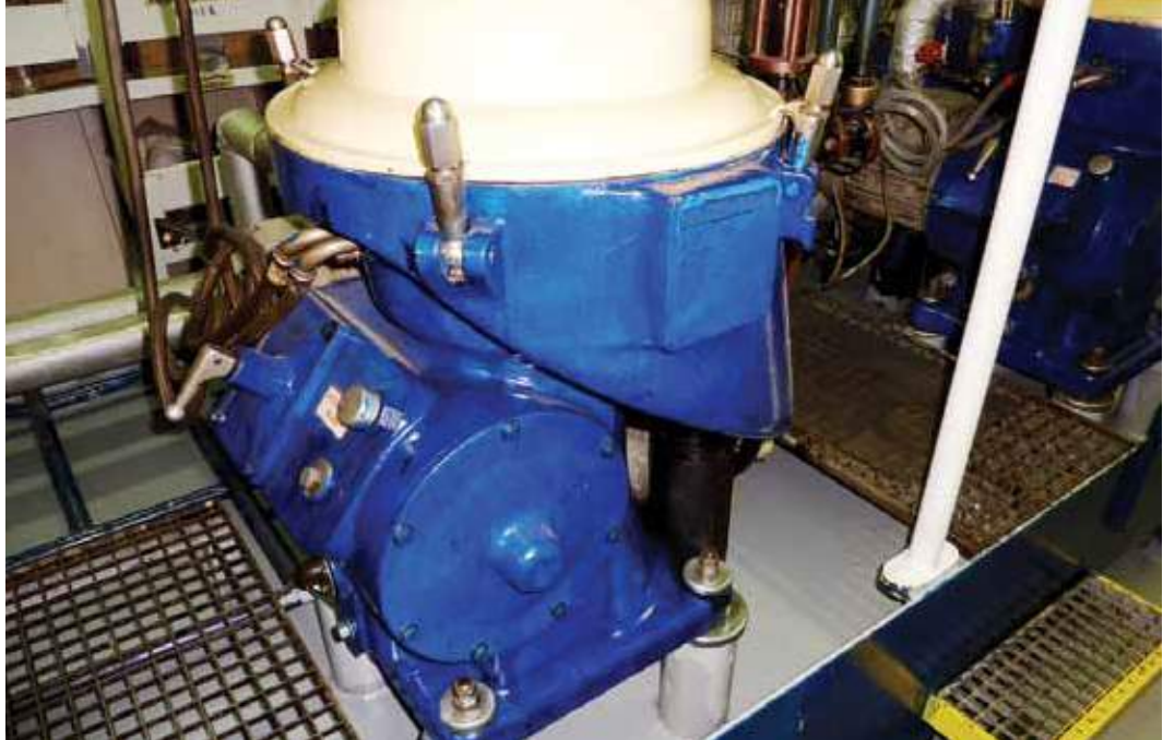
^ Centrifugal separator (purifier)
