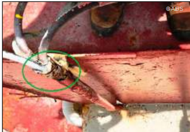
Conduit pipe corroded
