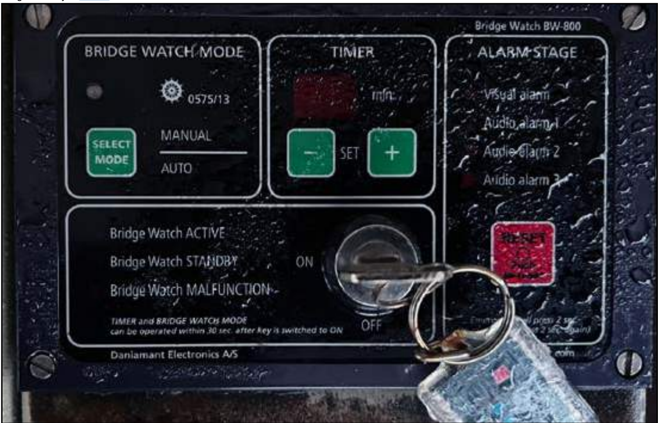
Figure 26: Karin Høj's BNWAS control panel
